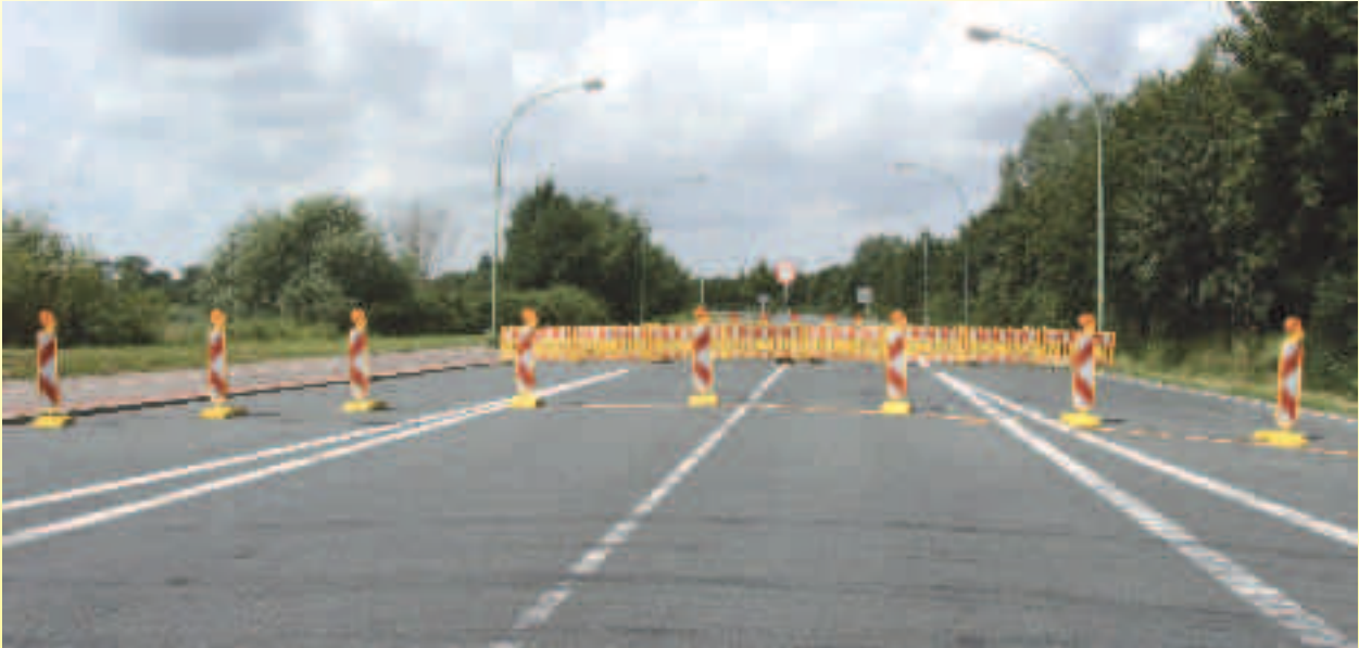
Weiß/rote Richtungsbaken an einem Wendehammer
